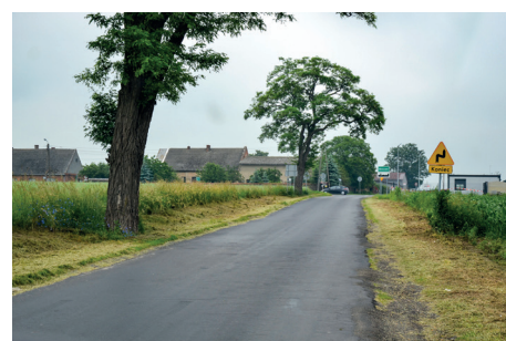
Mroczeń - droga do remontu
